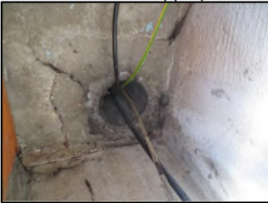
Photo N° 665 AMIANTE CIMENT -- Gaine technique Gaz - 4 Conduits Ventilation haute (Fibres-ciment)
